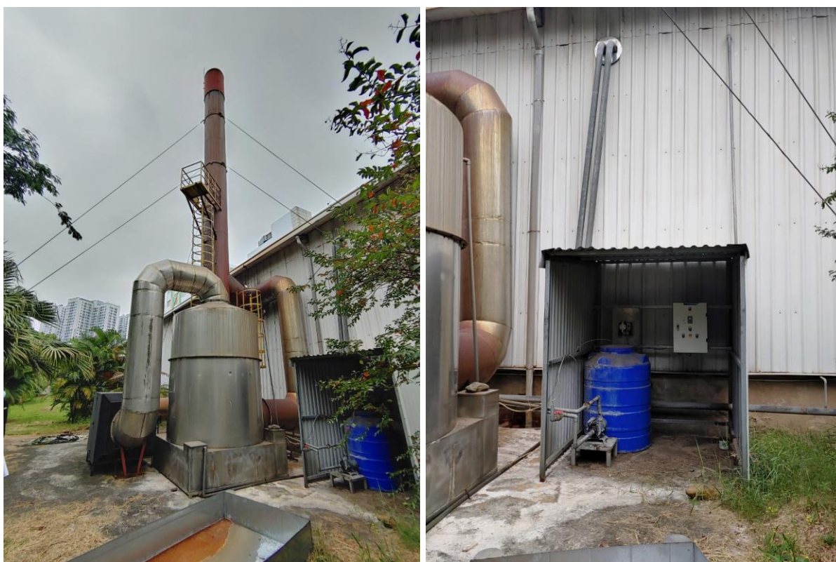
Hình 6. Hệ thống xử lý khí thải lò hơi
