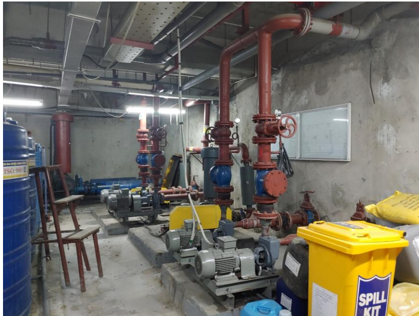
Hệ thống máy bơm
