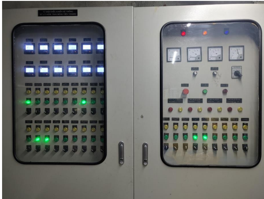
Tủ điều khiển
