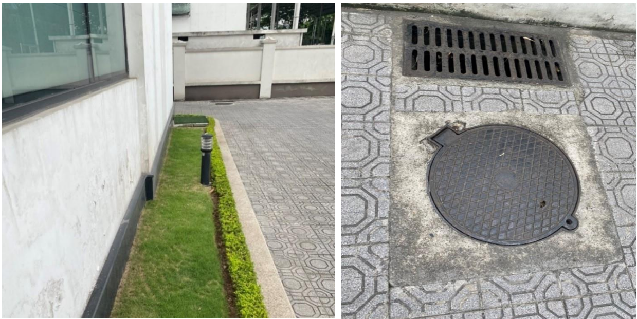
Hình 6. Khu vực bố trí bể xử lý nước thải tại phòng khám đa khoa quốc tế Vinmec
